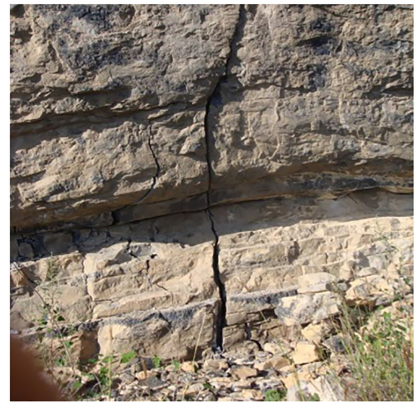
图 2 下宽上窄裂缝图
